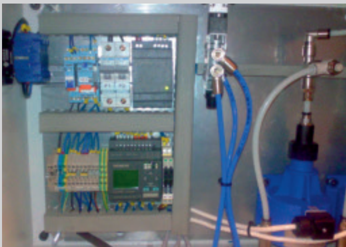
Elskåp med styrning och elektropumpar Electric cabinet and electro pumps Schaltkasten mit Steuerung und Elektropumpen
